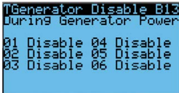
FIGURA 19 Selección de unidades operativas con generador en funcionamiento
